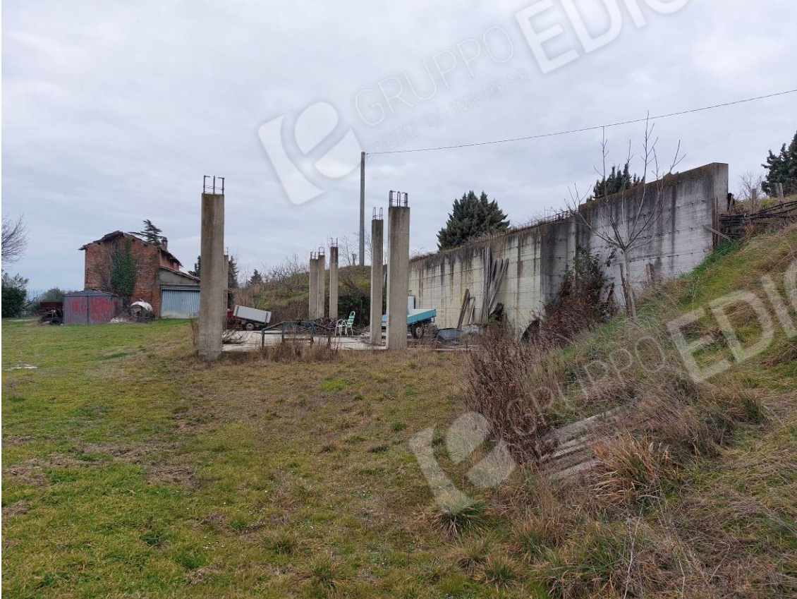
Fabbricato in costruzione in stato di abbandono
