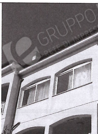
Balcone primo piano Finestrato abusivamente
