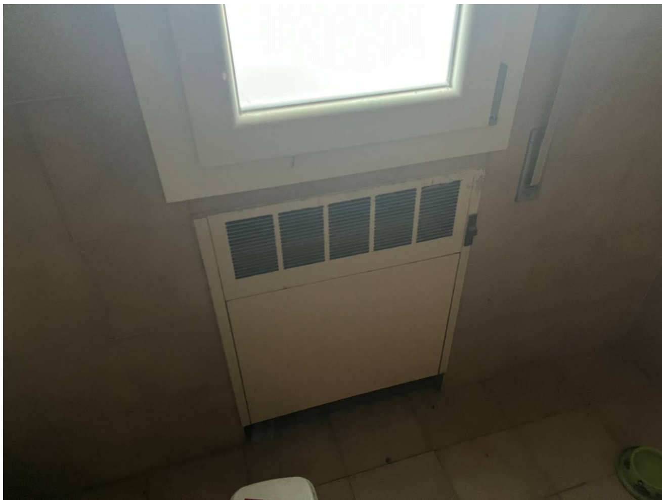
11. Dettaglio serramenti e ventilconvettori
