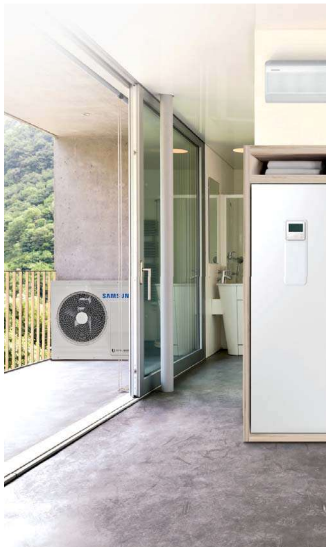
Pompa di calore per riscaldamento e condizionamento
