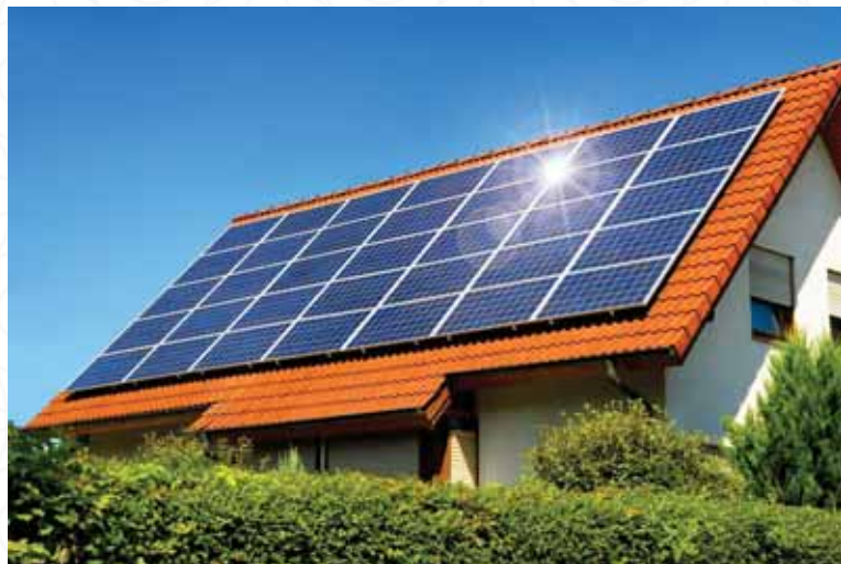
Impianto fotovoltaico singolo
