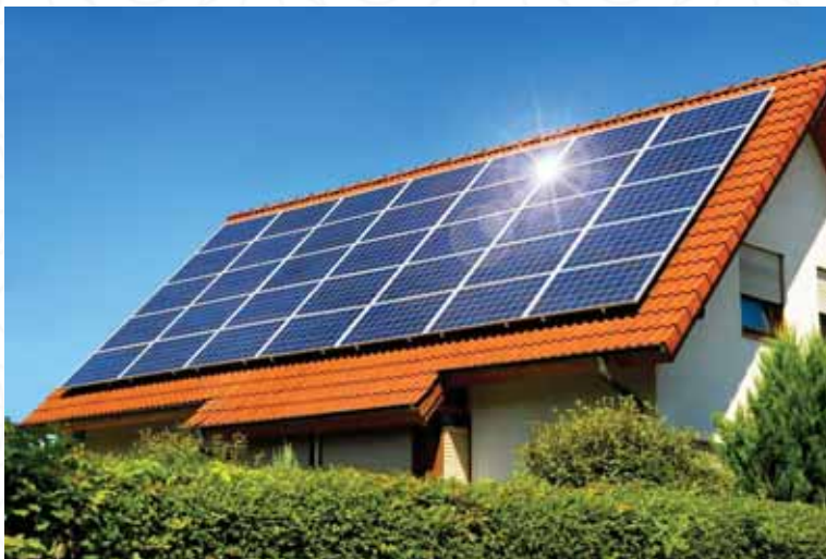
Impianto fotovoltaico singolo
