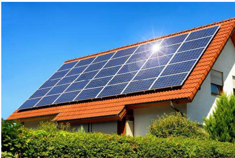
Impianto fotovoltaico singolo
