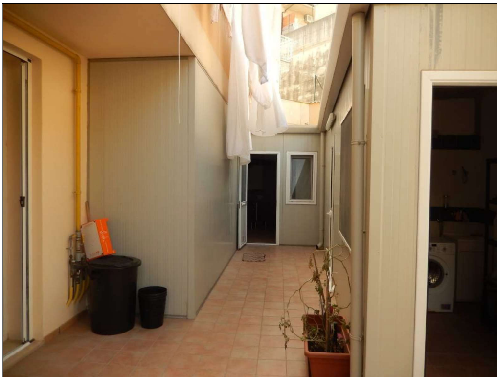
Foto 14: Veranda esterna al Piano Terra con strutture precarie zona cucina e servizi
