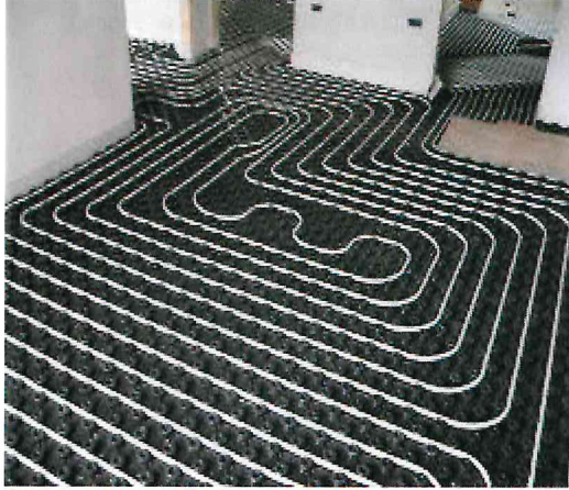
Part. impianto radiante a pavimento
