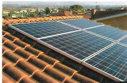
Particolare pannelli fotovoltaici
