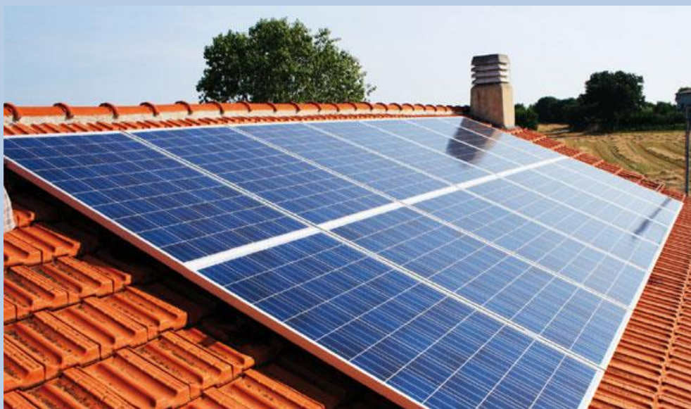
Esempio: pannelli fotovoltaico sul tetto
