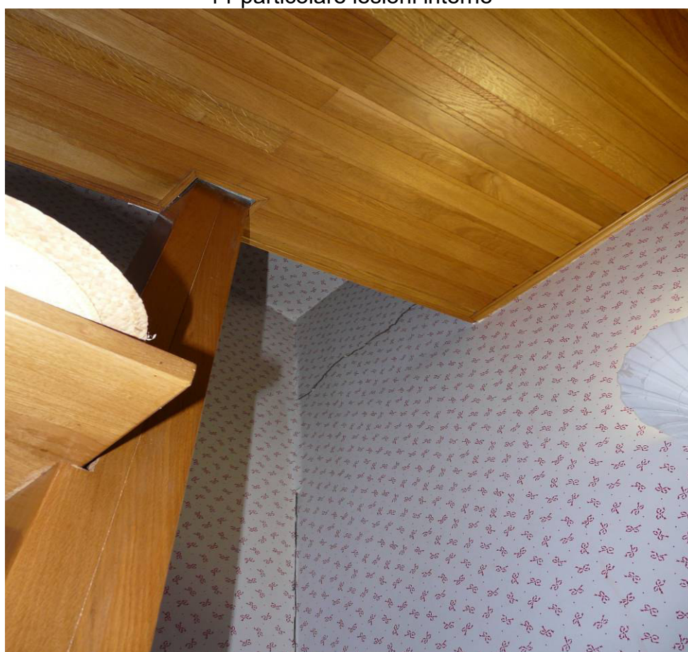
15-particolare lesioni interne
