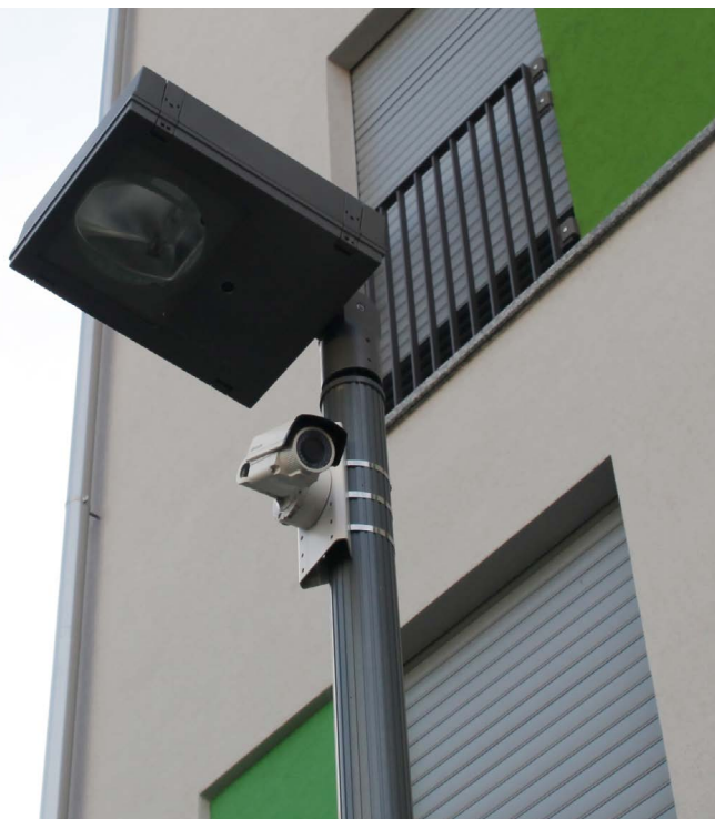
PREDISPOSIZIONE IMPIANTO VIDEOSORVEGLIANZA
