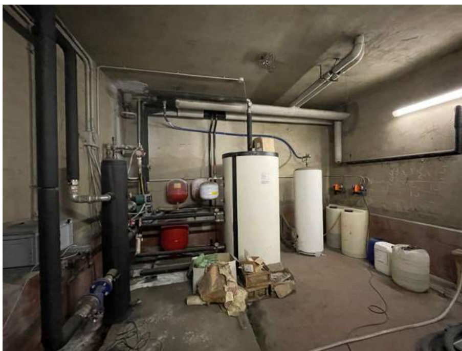
F41: piano seminterrato – locale tecnico
