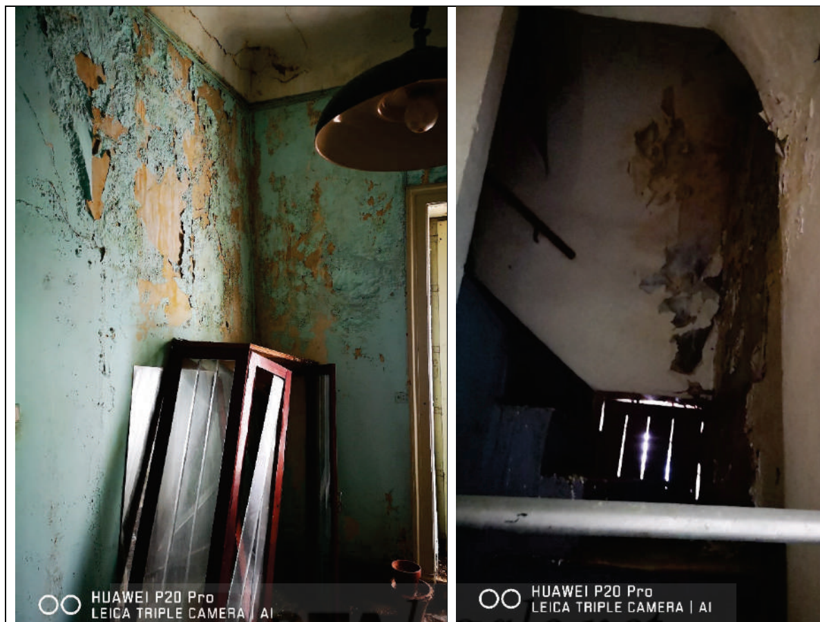
Foto n.8 : Alcuni pinti infiltrazione acqua piovana
