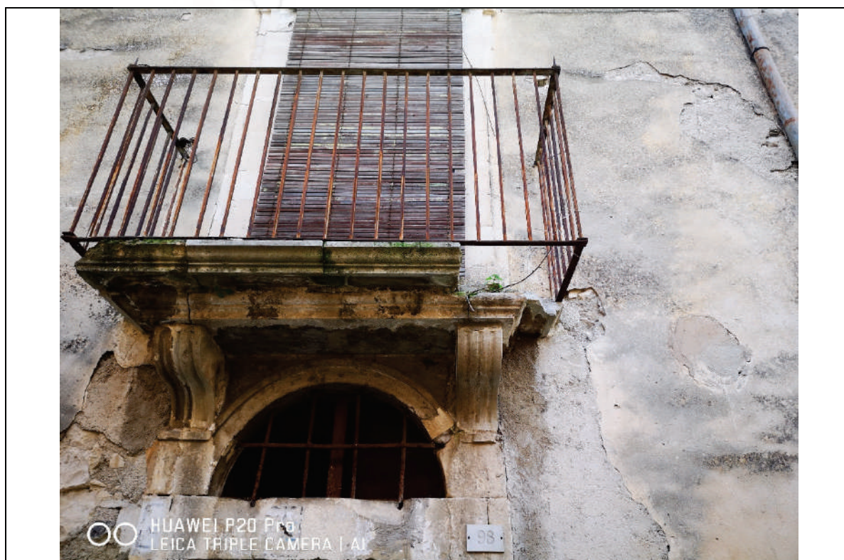
Foto n.9: Balcone deteriorato – Locale 1
