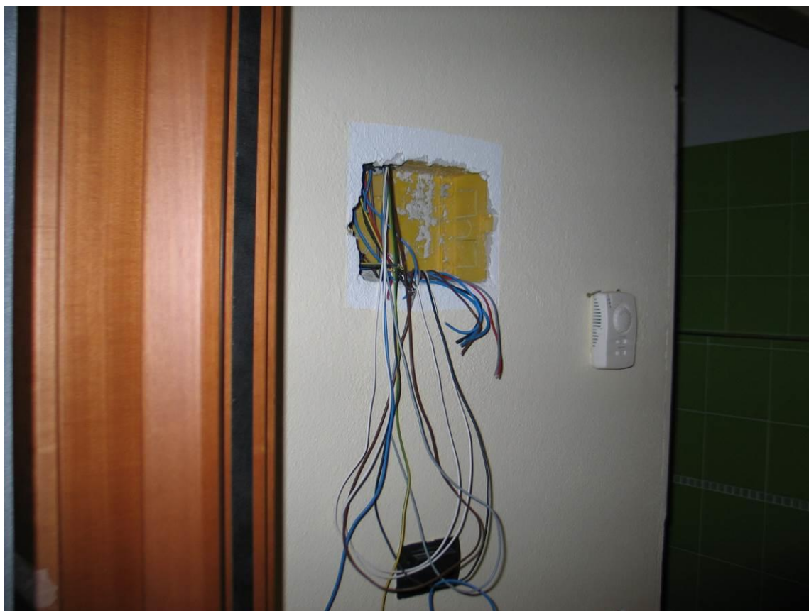
Foto 28 – primo piano - impianto elettrico camera
