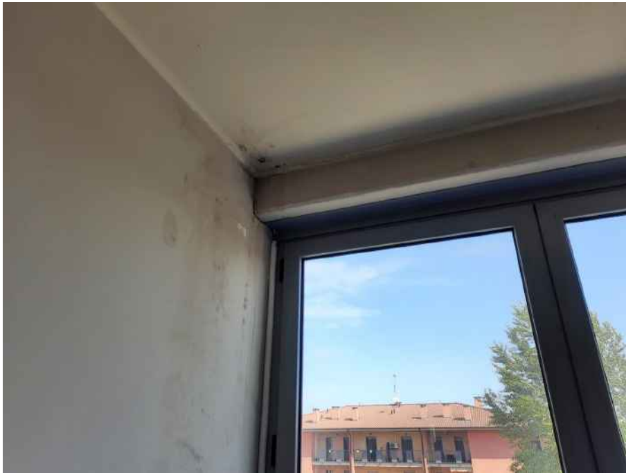
FOTO 17: INFILTRAZIONE DI ACQUA PIOVANA
