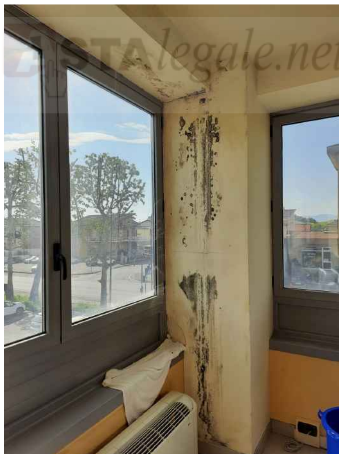
FOTO 16: INFILTRAZIONE DI ACQUA PIOVANA
