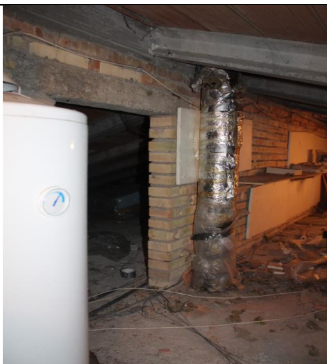
PARTICOLARE DI UNA CANNA FUMARIA STUFA, COLLOCATA AL PIANO SOTTOSTANTE
