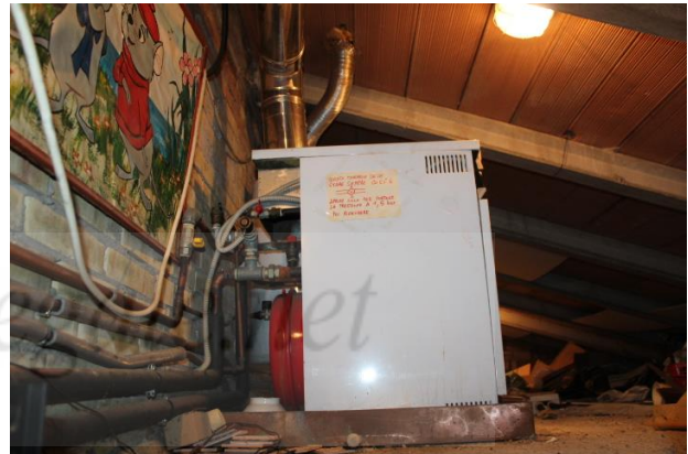
SOTTOTETTO, PARTICOLARE CALDAIA (non funzionante)
