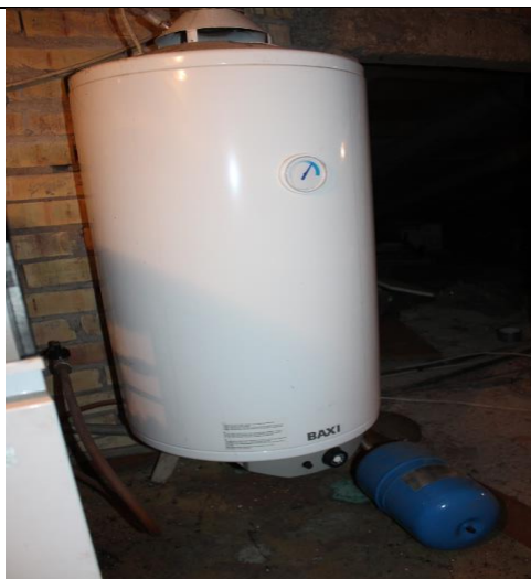
BOILER ACQUA SANITARIA
