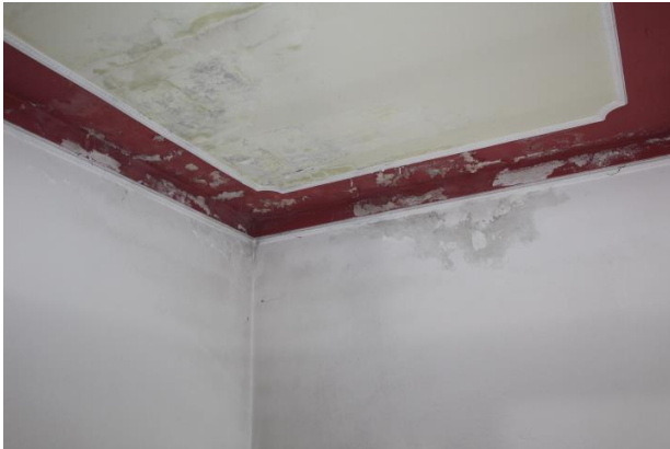
PARTICOLARE INFILTRAZIONI D'ACQUA NEL VANO SCALA
