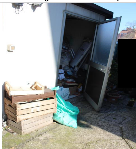
DALL'ESTERNO, ACCESSO AD ALTRO VANO (in parte NON regolare e da demolire)
