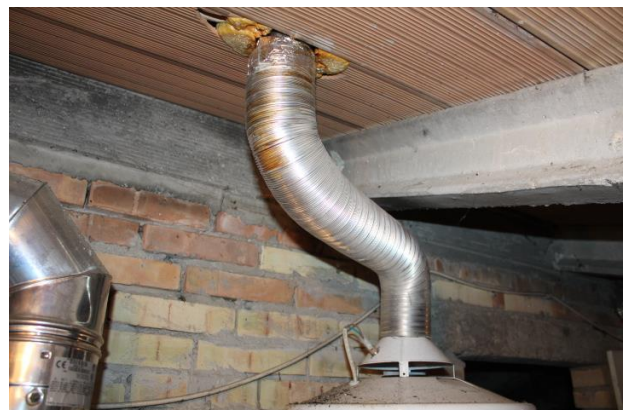
CANNA DI ESALAZIONE FUMI BOILER
