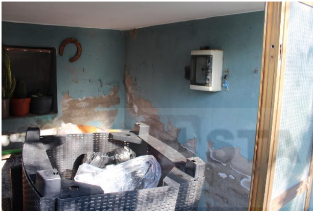
PARTICOLARE RIPOSTIGLIO COMUNE. PARTICOLARE UMIDITA' ASCENDENTE SULLE MURATURE.
