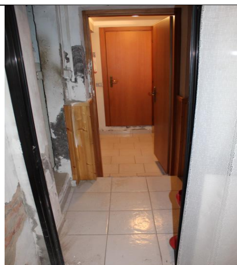
DALLA CENTRALE TERMICA, VISTA VERSO IL DISIMPEGNO
