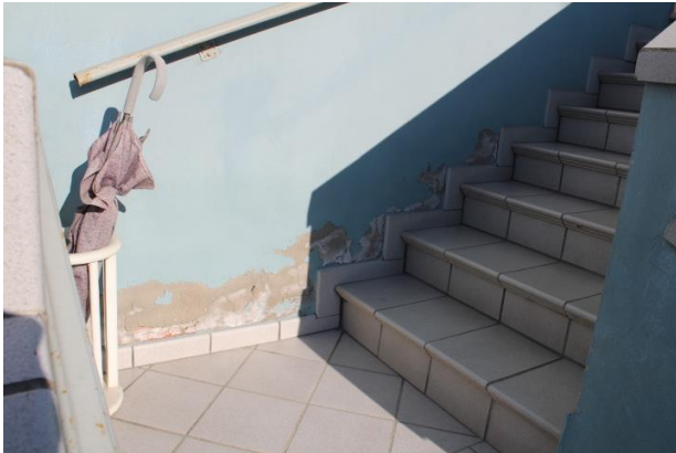
PARTICOLARE UMIDITA' ASCENDENTE SULLE MURATURE
