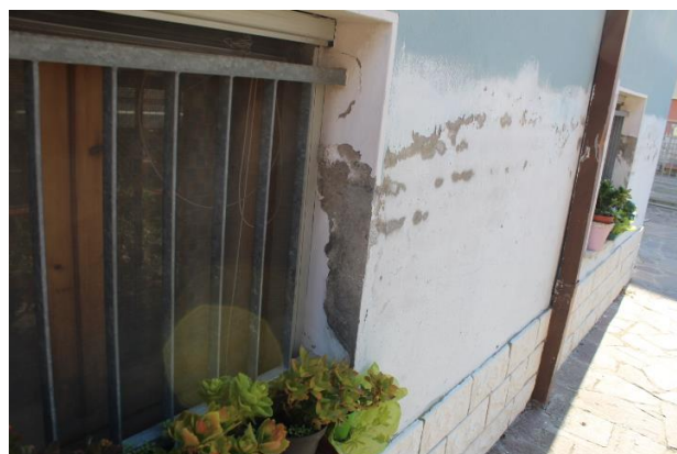
PARTICOLARE UMIDITA' ASCENDENTE SULLE MURATURE
