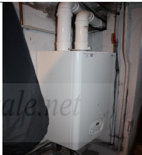
CALDAIA CHE SERVE IL PIANO RIALZATO ED I SERVIZI COMUNI ALL'INTERRATO
