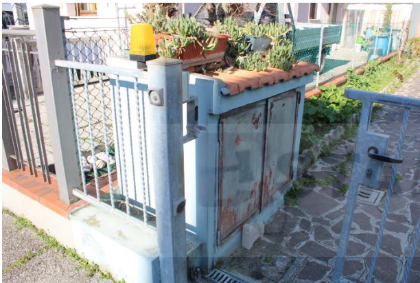
PARTICOLARE BOX CONTATORI ACQUA E GAS
