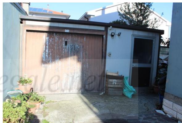
MANUFATTO SUL RETRO (in parte abusivo e da demolire) DEL LOTTO 3
