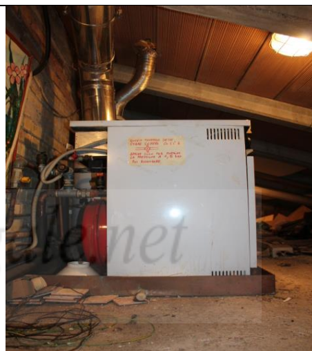
CALDAIA NEL SOTTOTETTO (non funzionante)
