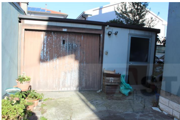
MANUFATTO ESTERNO (non regolare ed in parte da demolire)
