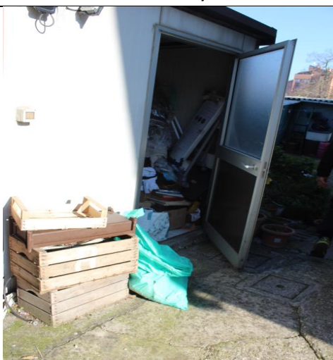
DALL'ESTERNO, INGRESSO NEL VANO 2 (non regolare ed in parte da demolire)
