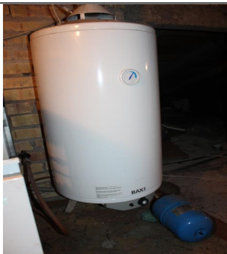
BOILER PER ACQUA SANITARIA NEL SOTTOTETTO
