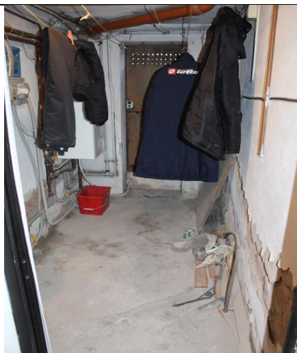
CENTRALE TERMICA CON CALDAIA APPARTAMENTO LOTTO 2, CHE SERVE ANCHE I SERVIZI COMUNI AL SEMINTERRATO
