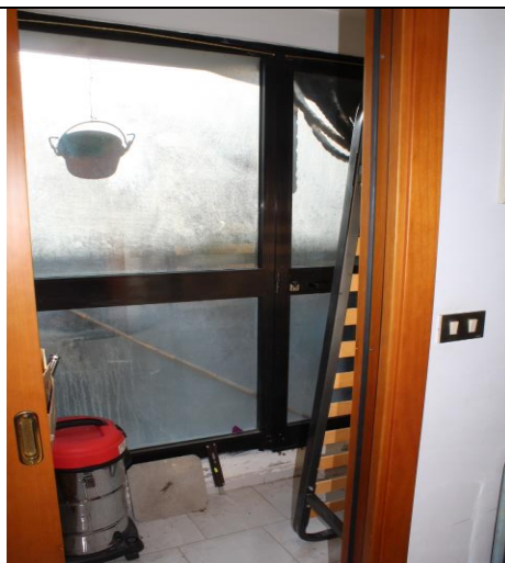
ZONA RICAVATA FRA IL PORTONE ESTERNO E LA PARETE (non regolare, da demolire) REALIZZATA NELL'AUTORIMESSA
