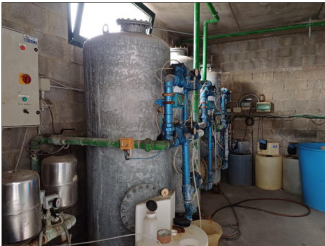
Foto 24 – fabbricato secondario – locale pompe e gruppo antincendio
