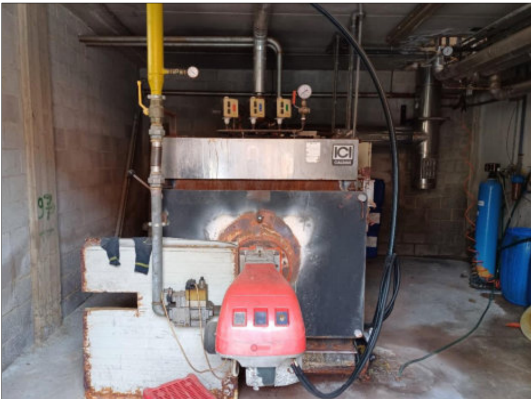
Foto 26 – fabbricato secondario – centrale termica
