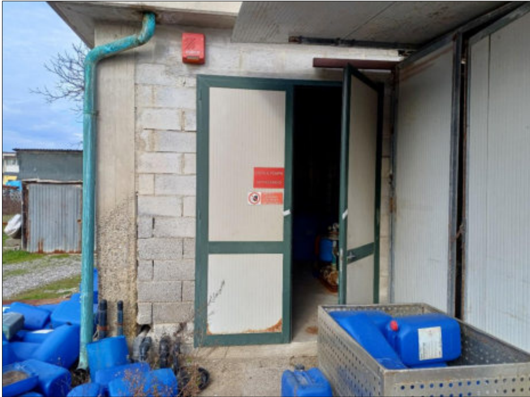
Foto 23 – fabbricato secondario – locale pompe e gruppo antincendio
