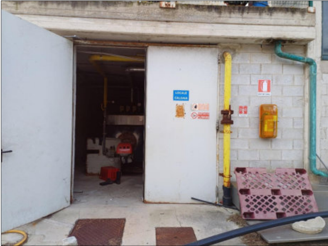
Foto 25 – fabbricato secondario – centrale termica
