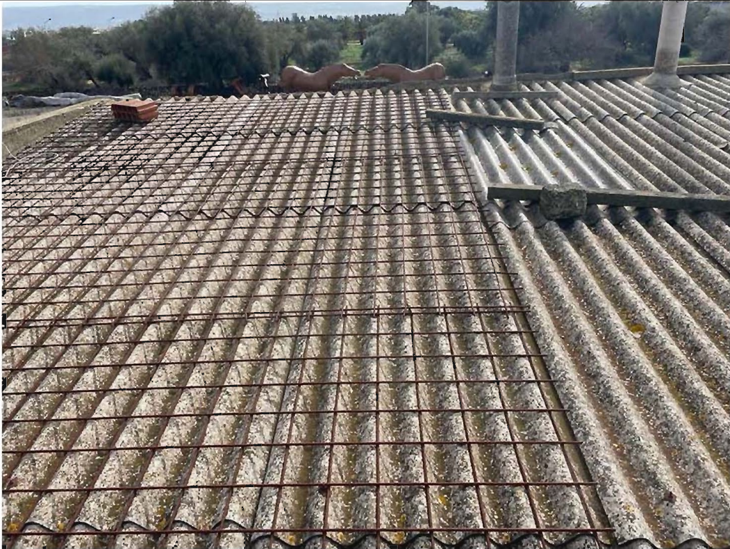
Copertura in eternit
