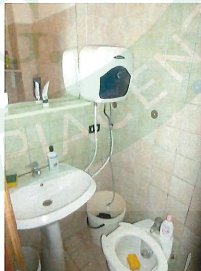
boiler elettrico marca Ariston posto nel bagno.
