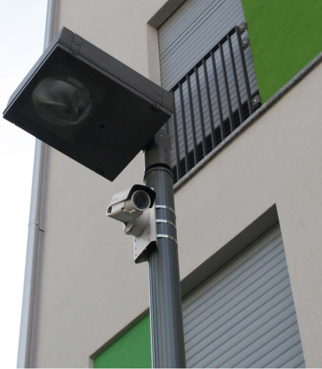
PREDISPOSIZIONE IMPIANTO VIDEOSORVEGLIANZA
