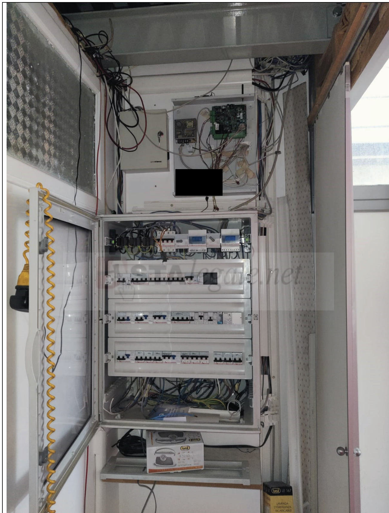
Quadro elettrico esistente
