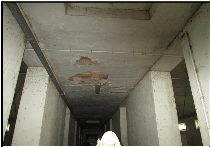
Foto n°13 - Magazzino, uffici ed abitazione Magazzino soffitto del disimpegno
