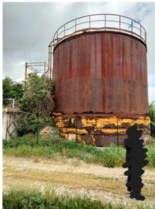
SERBATOIO ACCUMOLO n°7
