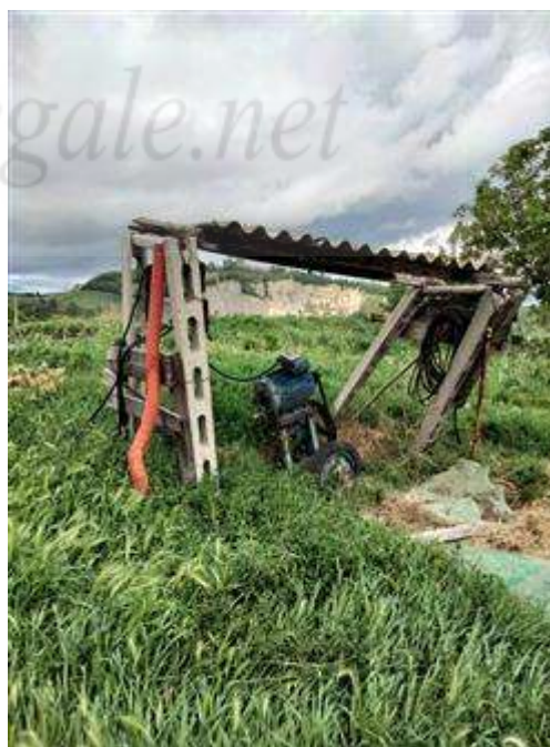
POMPA ASPIRAZIONE LIQUAMI DAL LAGONE
