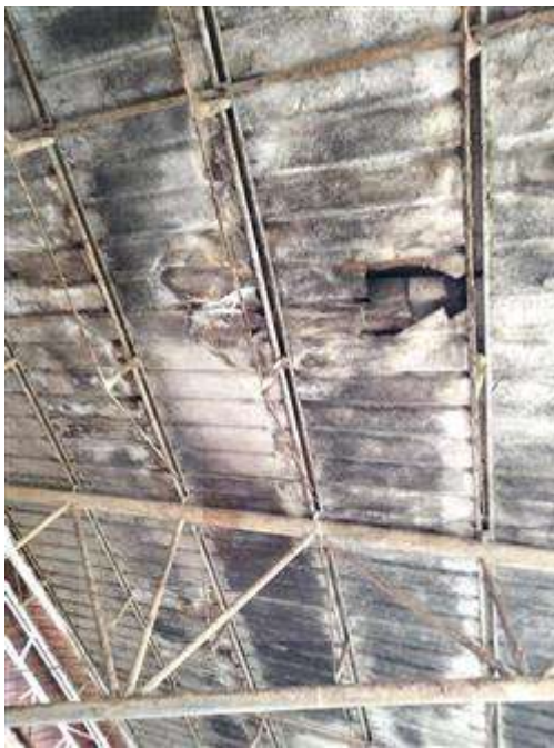
PARTICOLARE CEDIMENTO COPERTURA
