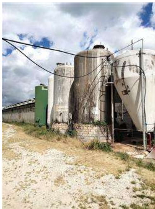
serbatoi stoccaggio acqua e siero
