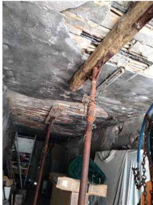
PARTICOLARE SEL SOLAIO PERICOLANTE
