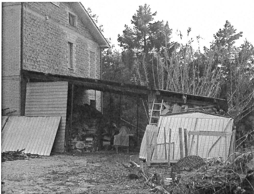
EDIFICIO PRINCIPALE (tettoia abusiva da demolire)
