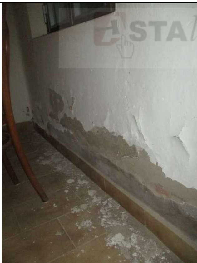
Stato di ammaloramento della muratura interna.
