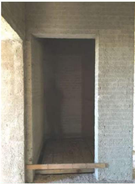
FOTO 78 ta Interno Ascensore Piano Primo
