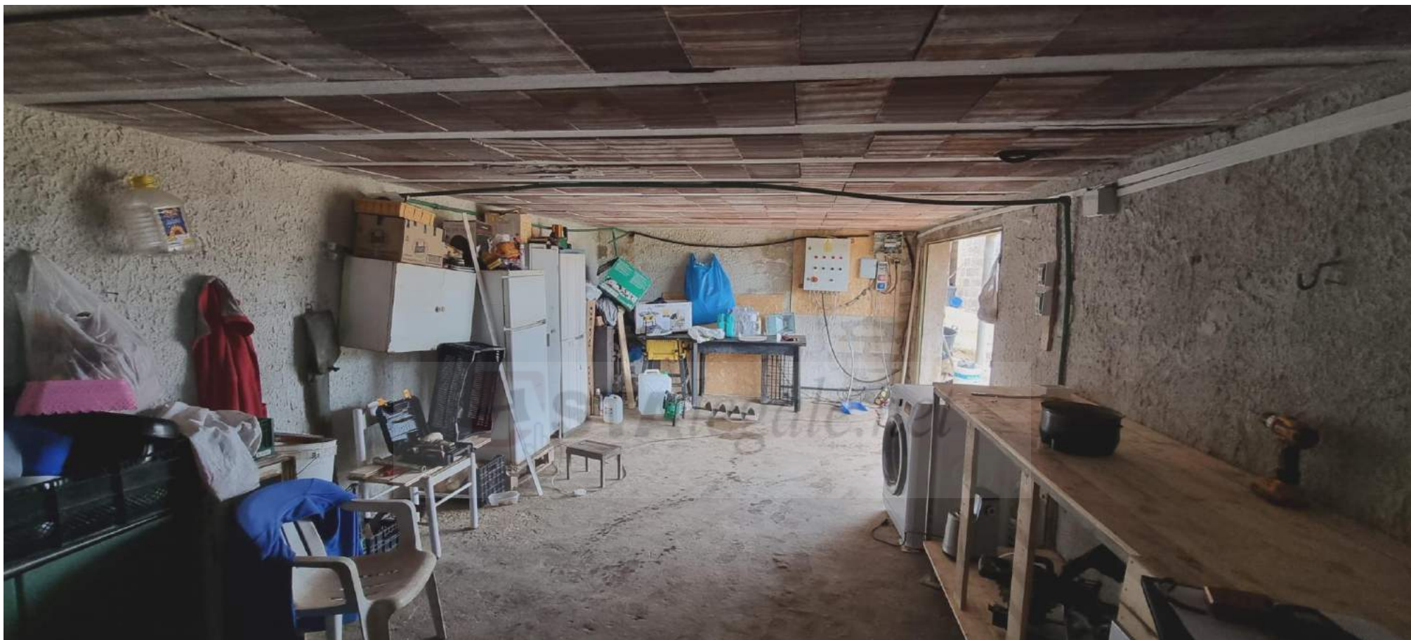
Foto n. 29 - Secondo fabbricato (particella 474, parte abusiva) - Vano di sgombero/cucina abusivamente realizzato nel seminterrato.
