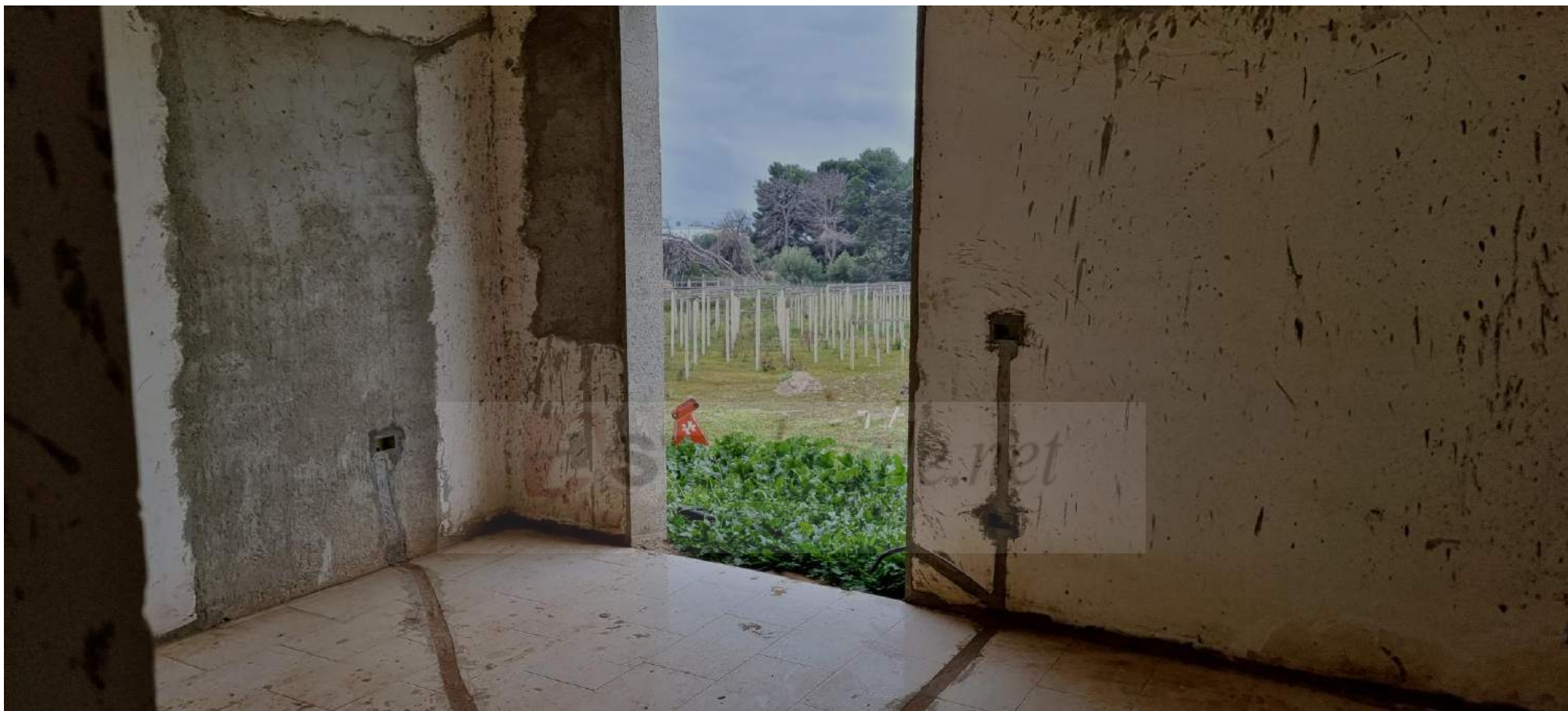
Foto n. 14 - Primo fabbricato (particella 404, sub 1, A/3 di 1ª classe) - Interni sostanzialmente allo stato rustico.
