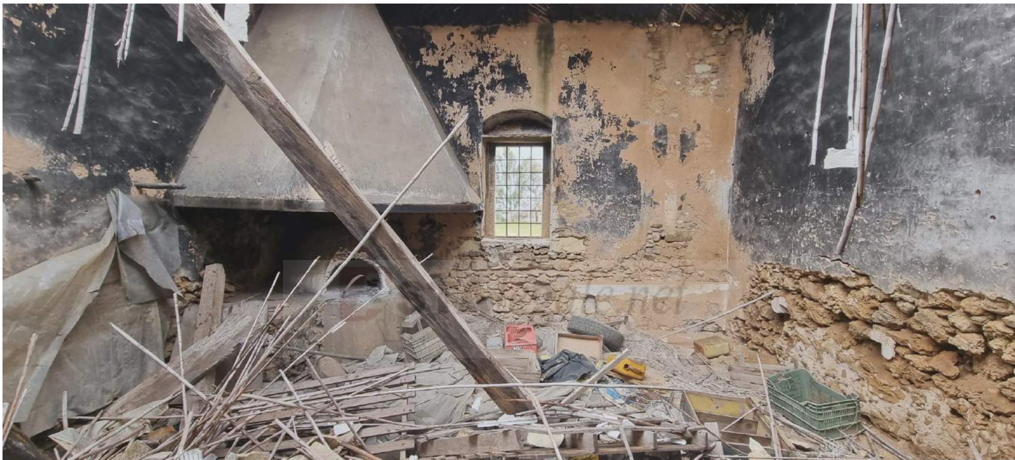
Foto n. 36 - Quarto fabbricato (particella 661, sub 1, D/10) - Vecchia casa del forno in pessime condizioni
