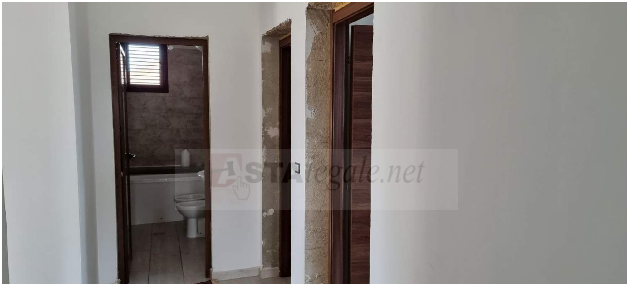
Foto n. 32 - - Secondo fabbricato (particella 474, sub 1, A/3 di 1ª classe) - Intonaco rustico nei vani porta interni.
