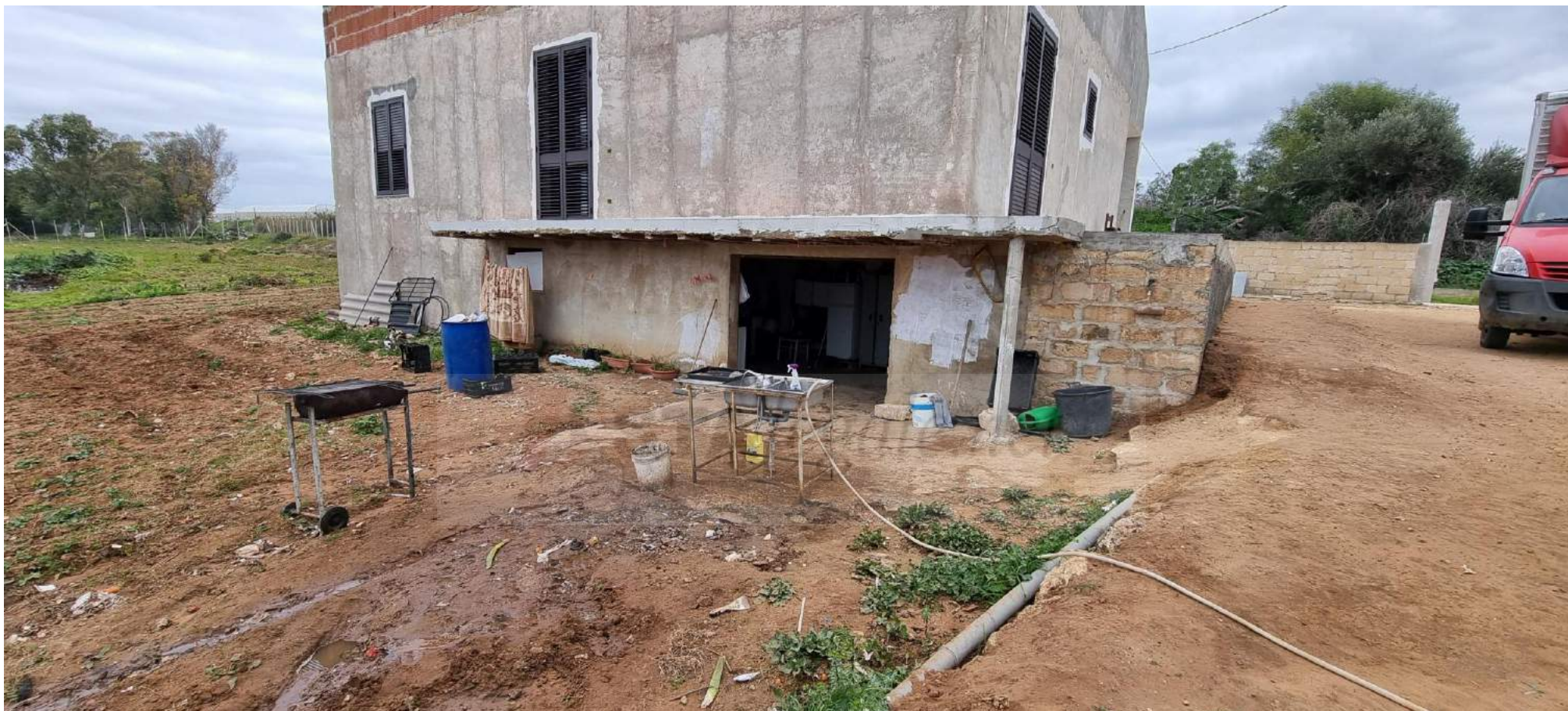
Foto n. 22 - - Secondo fabbricato (particella 474, sub 1, A/3 di 1ª classe) - Retrospetto a ovest. In primo piano il seminterrato realizzato abusivamente.
