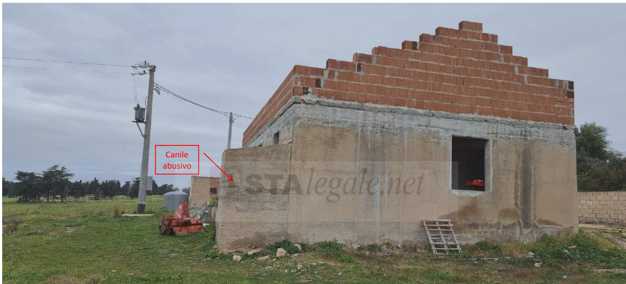
Foto n. 18 - Primo fabbricato (particella 404, sub 2, D/10) - Prospetto laterale (a sud) - Si notino la sopraelevazione e il casottino-canile, entrambi abusivi.
