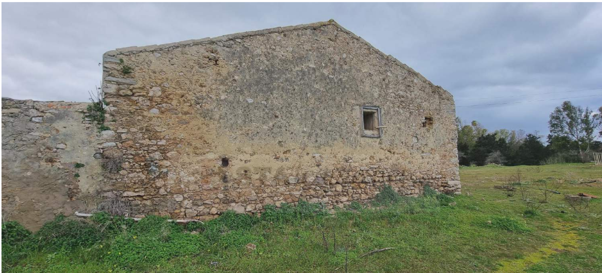
Foto n. 43 - Quinto fabbricato (particella 664, sub 2, A/4 di 2ª classe) - Prospetto laterale a nord profondamente deteriorato specialmente nella parte basale dei muri.
