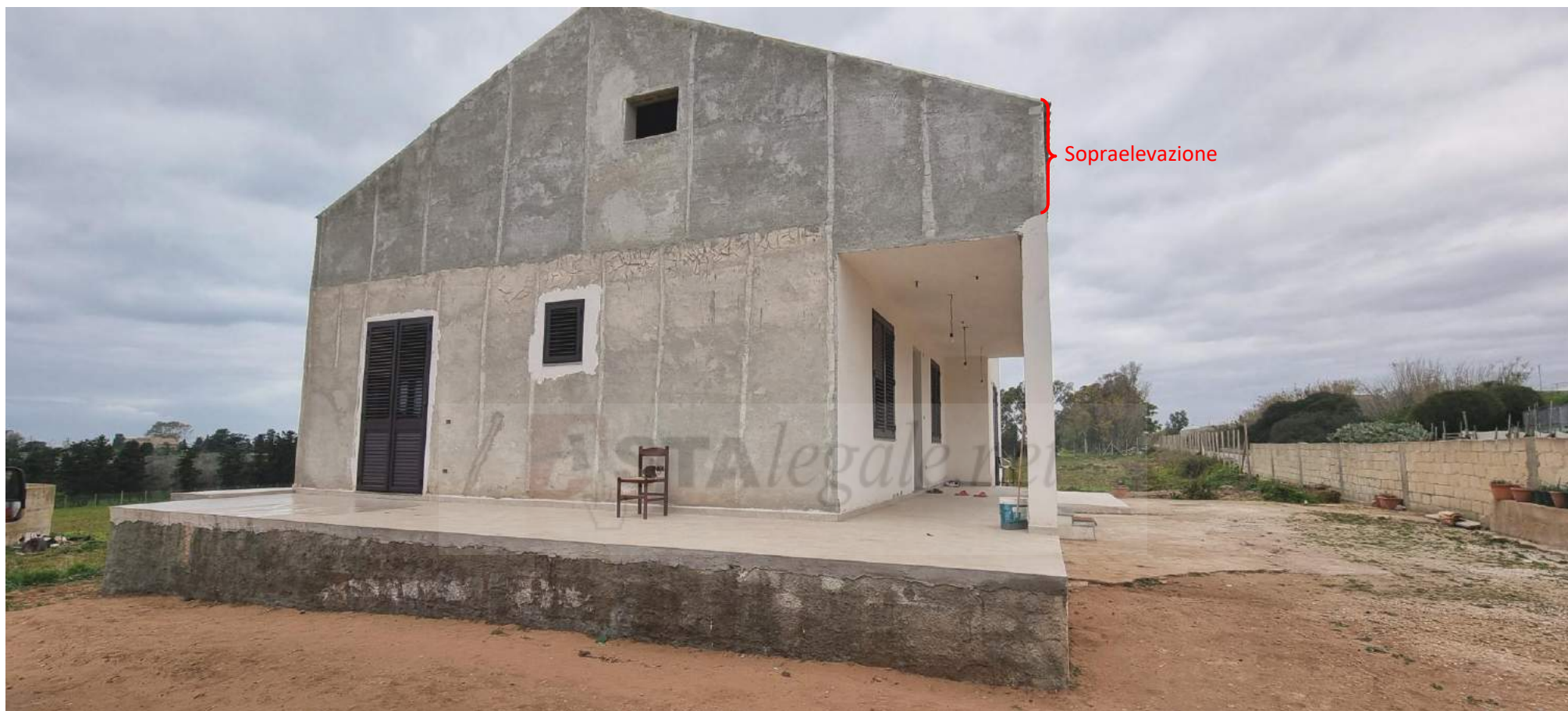
Foto n. 21 - Secondo fabbricato (particella 474, sub 1, A/3 di 1ª classe) - Prospetto sud. Si noti la sopraelevazione e la copertura a tetto entrambe abusive.
