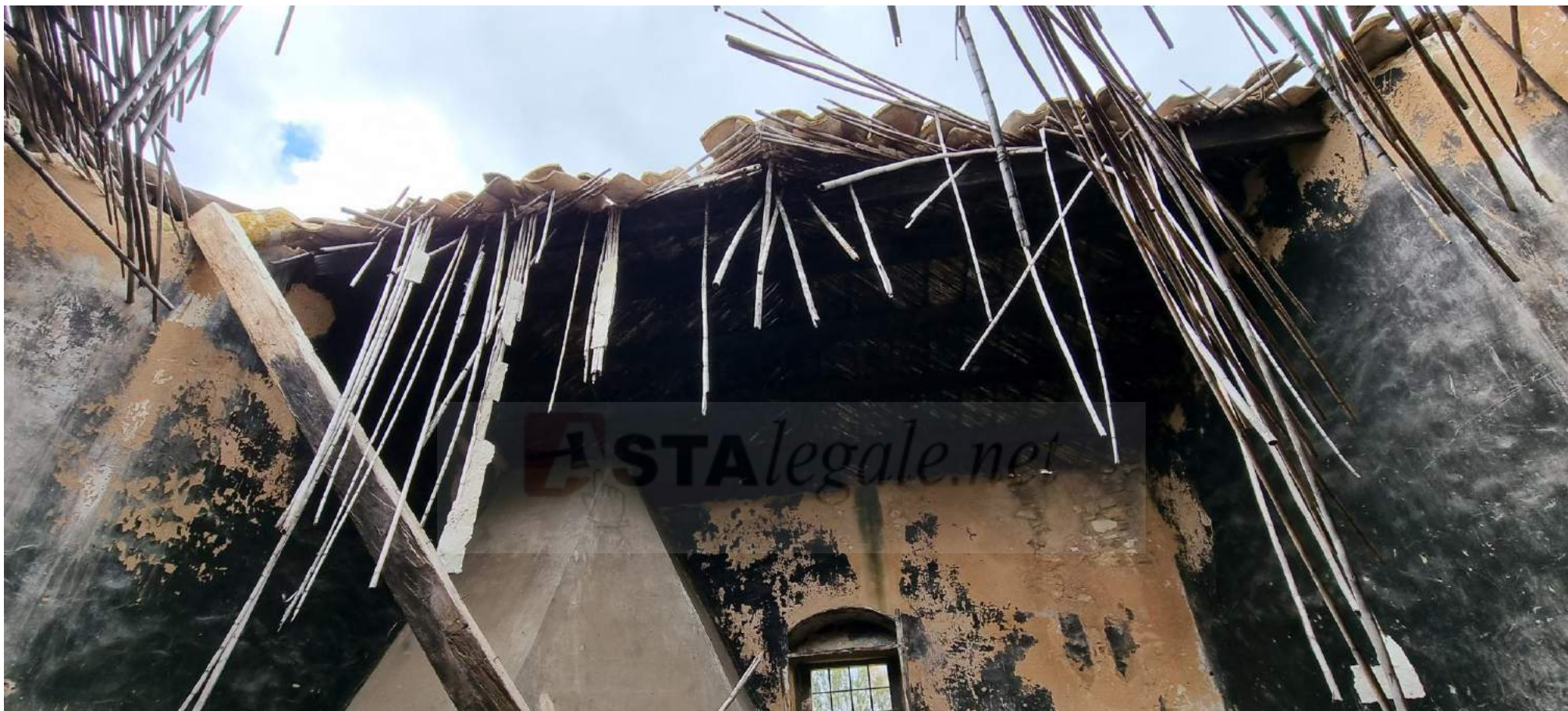
Foto n. 37 - Quarto fabbricato (particella 661, sub 1, D/10) - Idem. Si noti l'ampio squarcio del tetto
