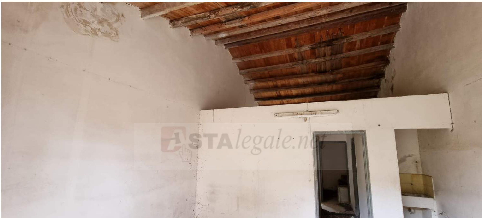
Foto n. 42 - Quinto fabbricato (particella 664 sub 2, A/4 di 2ª classe). Ingresso. Tetto ammalorato.
