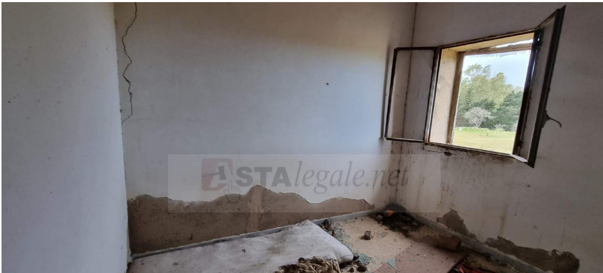
Foto n. 41 - Quinto fabbricato (particella 664 sub 2, A/4 di 2ª classe). Camera con intonaci scrostati e lesionati, infissi interni divelti (a terra) ed esterni inservibili.
