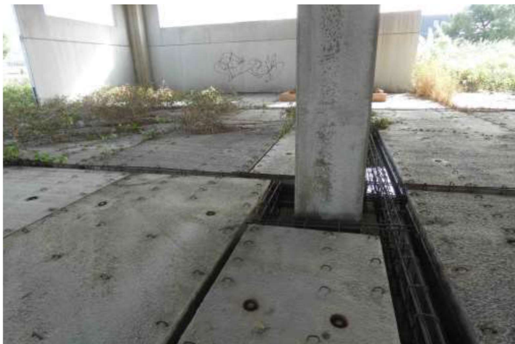
Foto 5 particolare dell'attacco tra il pilastro e il solaio di piano terra. Si notino i giunti tra le lastre con presenza di acqua
