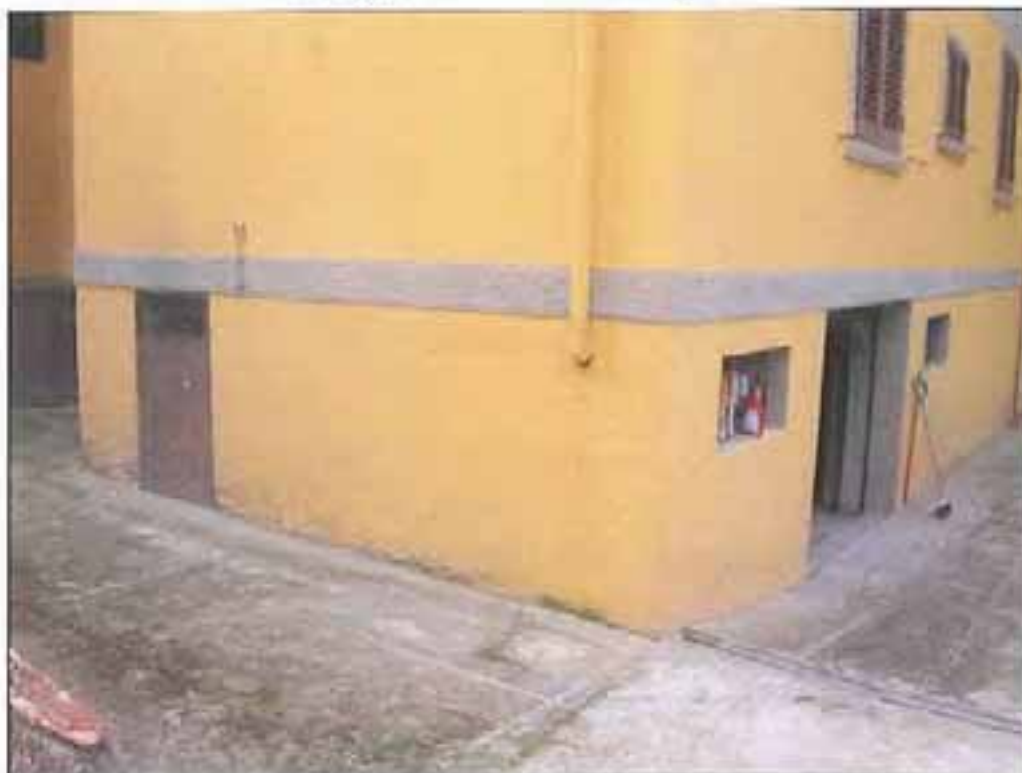
Fotografia 4: Vista dall'esterno della centrale termica
