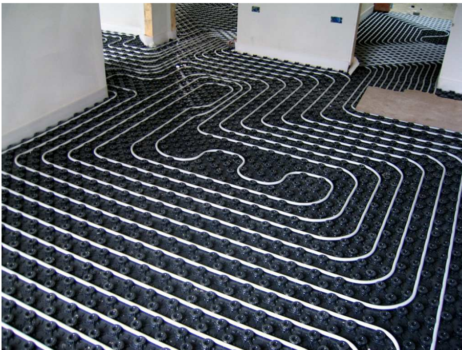
Impianto di riscaldamento a pavimento
