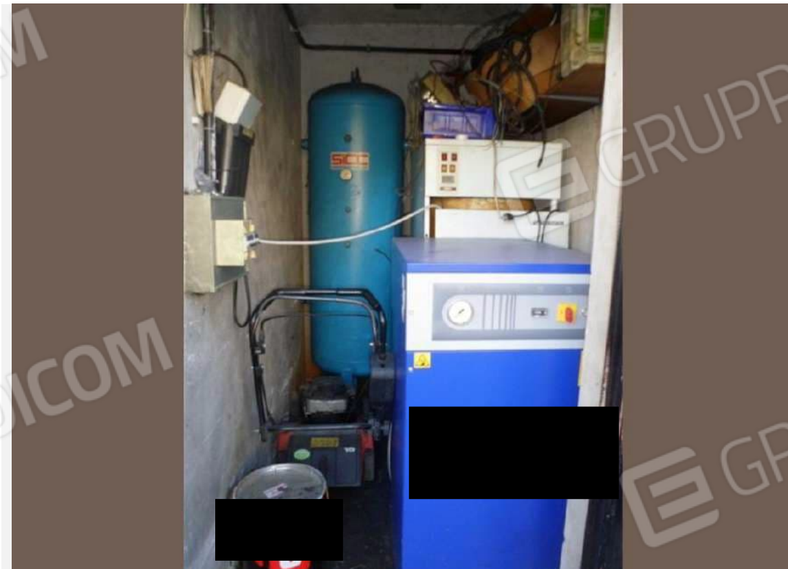
Foto 7. Dettaglio sala compressori
