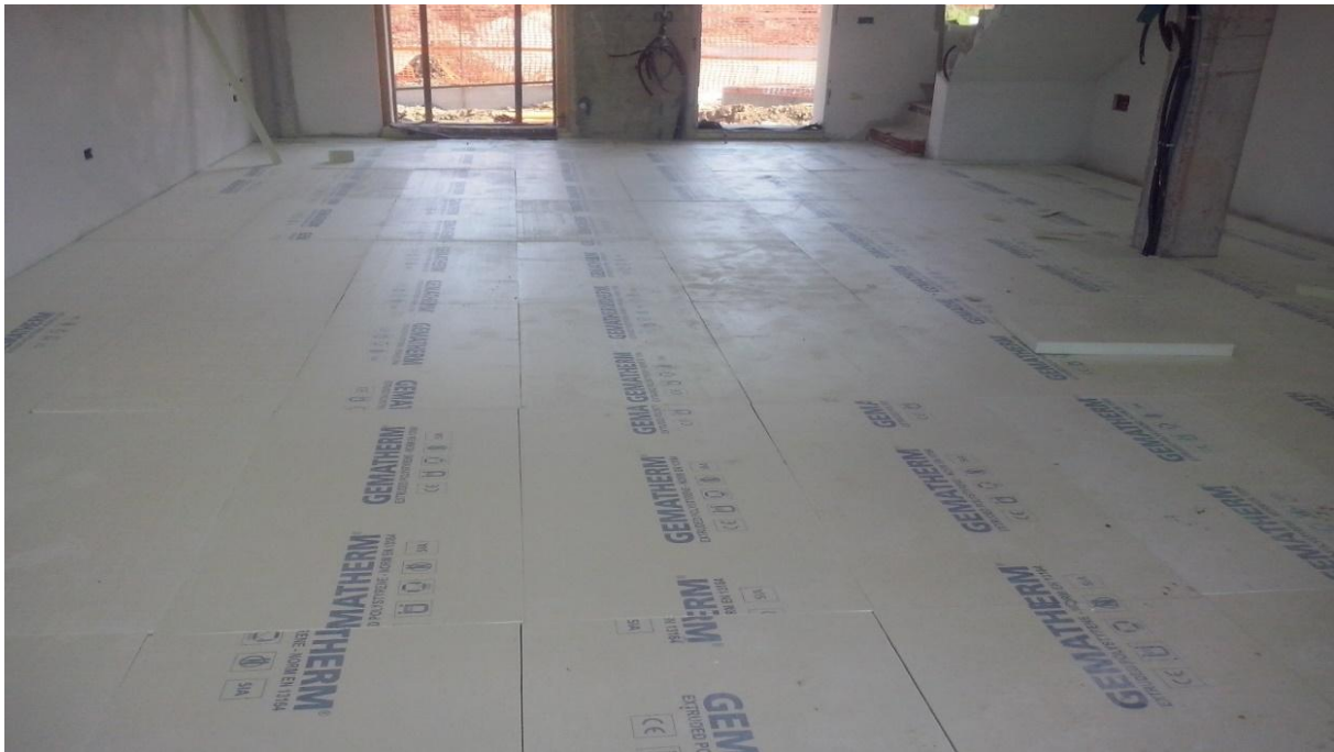
Particolare Isolamento sottostante l'impianto di riscaldamento a pavimento con polistirene xps spessore cm 5
