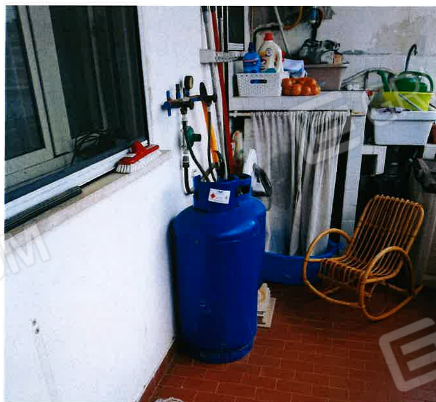
Foto n. 10 – Particolare della bombola di GPL per acqua calda sanitaria e cucina
