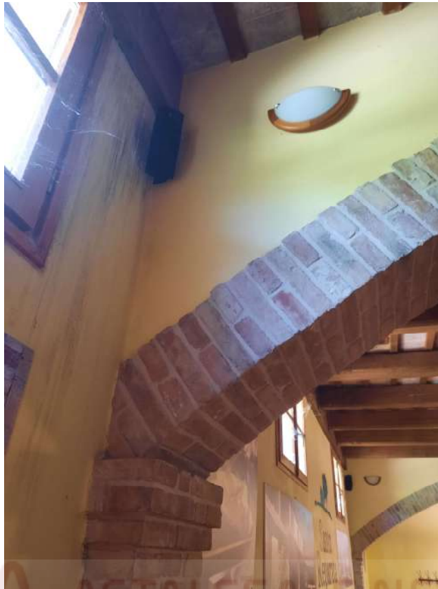
16 – VISTA INTERNA – SALA CON INFILTRAZIONI
