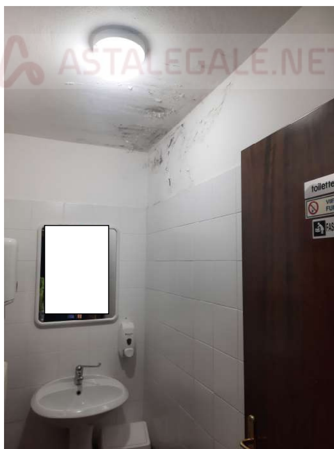
19 – VISTA INTERNA – SERVIZI CON INFILTRAZIONI
