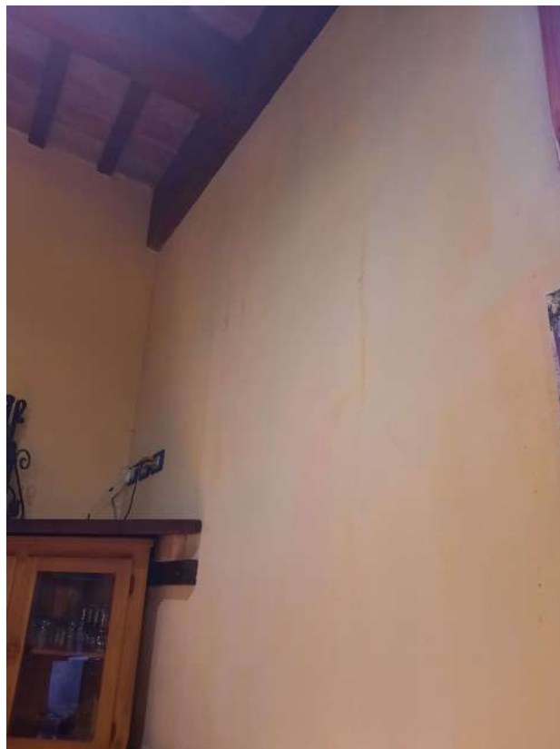
17 – VISTA INTERNA – SALA CON INFILTRAZIONI
