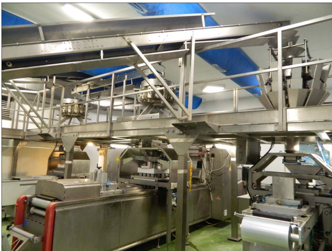
FOTO N. 11: PIANO TERRA -particolare macchinari e rifasatori "camera bianca"
