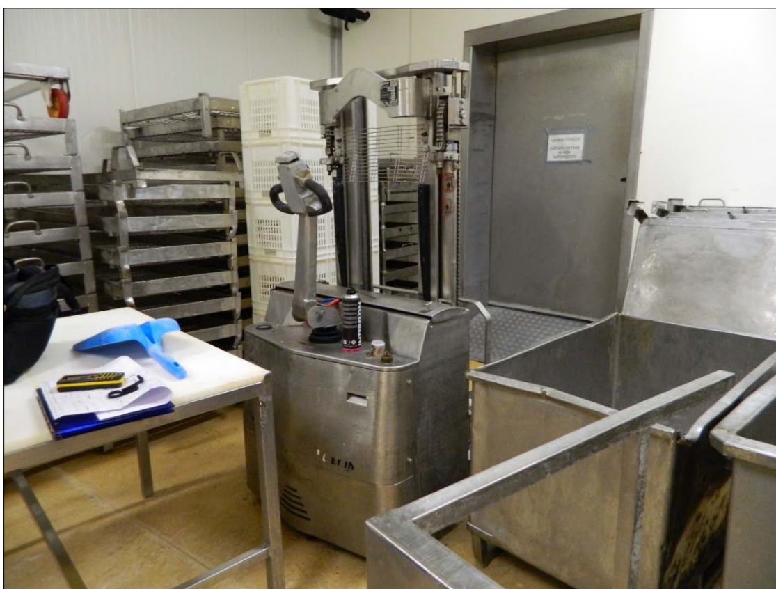
FOTO N. 2: PIANO TERRA -particolare muletto inox uomo a terra Samag "zona lavaggio"
