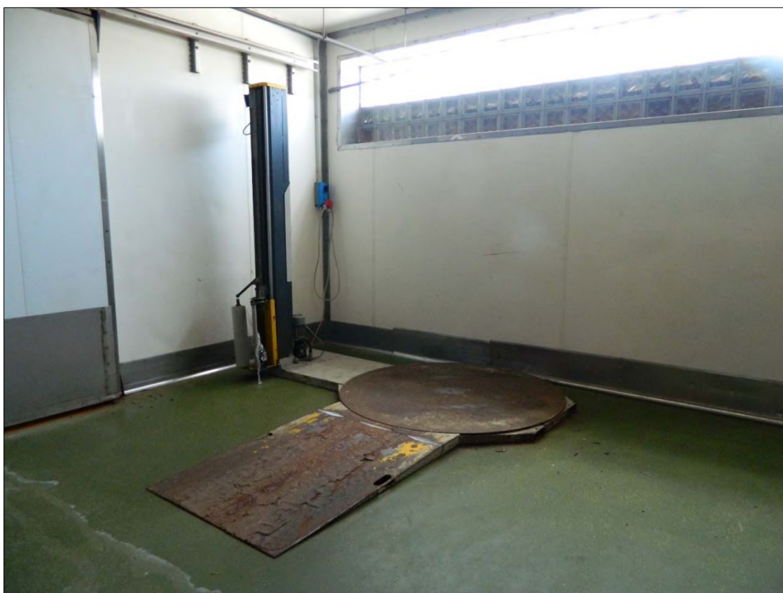
FOTO N. 22: PIANO PRIMO -particolare Fascia PLT automatica SIAT loc. "spedizione e carico"
