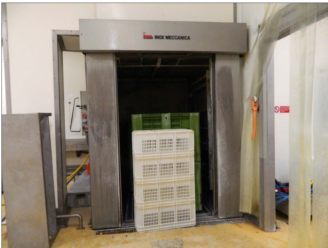
FOTO N. 3: PIANO TERRA -particolare lavacarrelli INOX MECCANICA "zona lavaggio"
