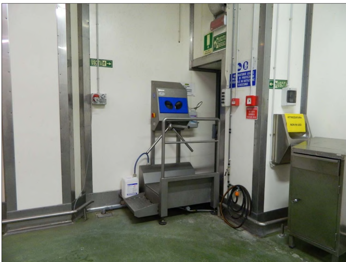
FOTO N. 16: PIANO TERRA -particolare zona ingresso con apparecchiatura "lavascarpe"
