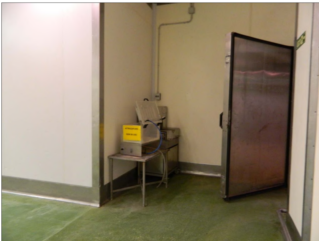
FOTO N. 15: PIANO TERRA -particolare imbrigliatrice Siebec -loc. confezionamento-
