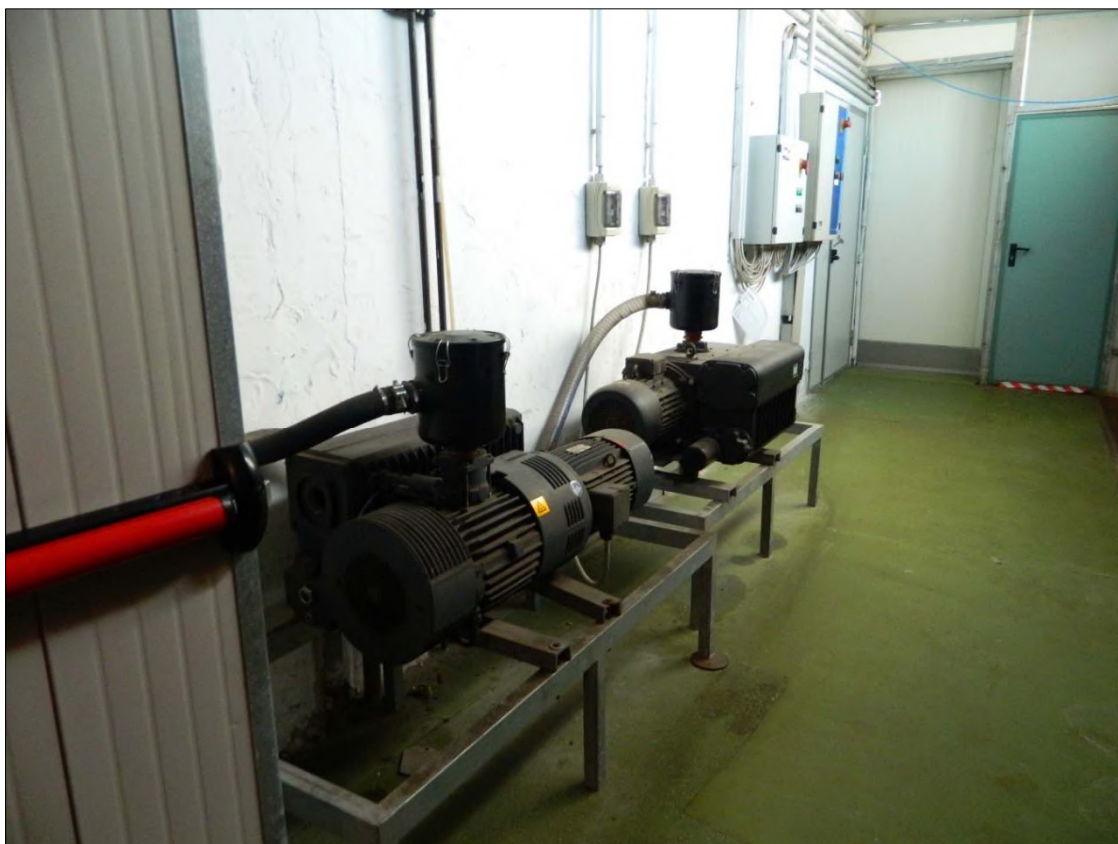
FOTO N. 28: PIANO PRIMO -particolare pompe loc. "soppalco deposito"
