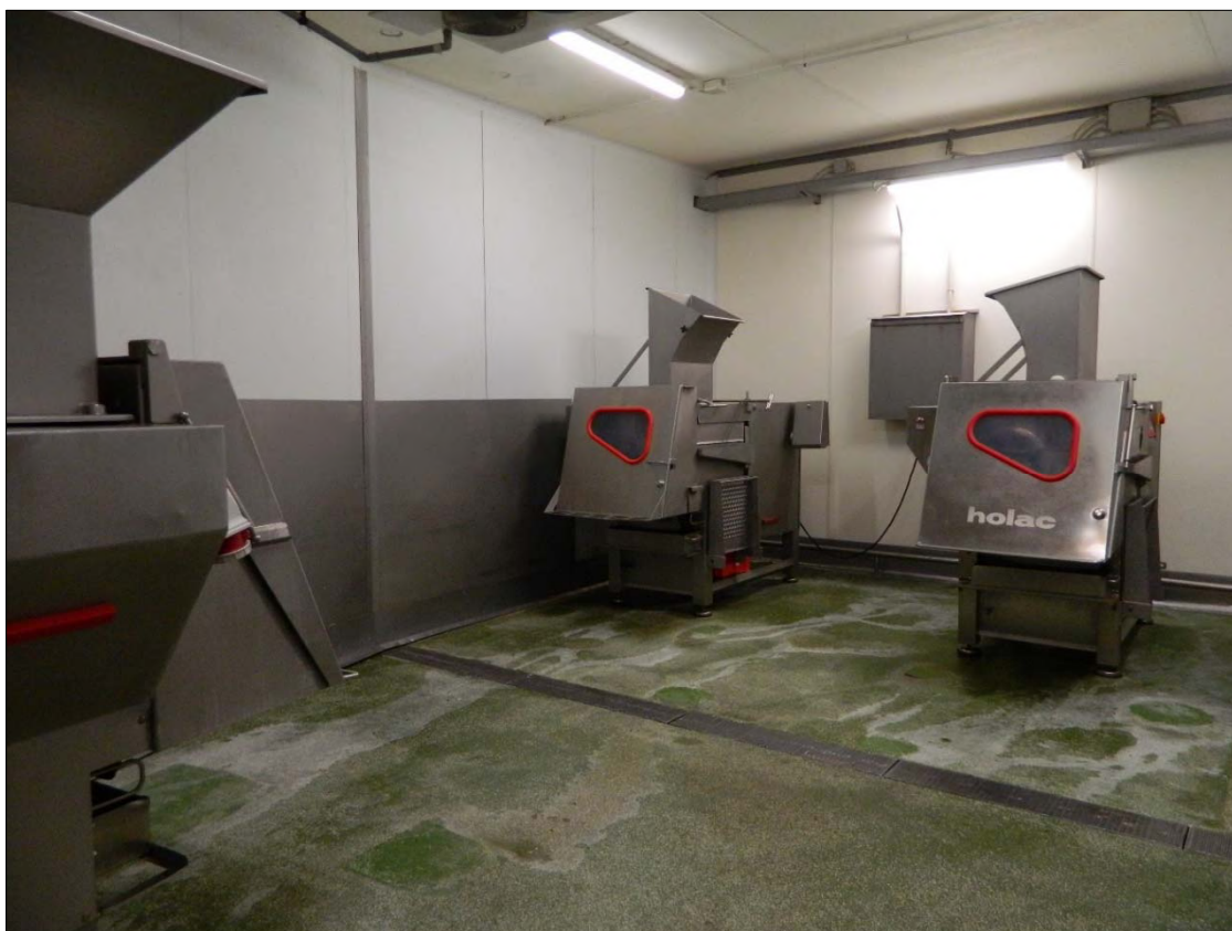
FOTO N. 9: PIANO TERRA -particolare cubettatrici Holac locale "cubettatura"
