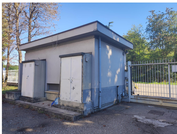
Cabina elettrica di proprietà
