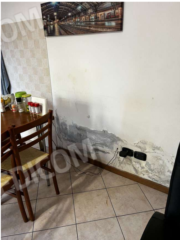
vista umidità interna della muratura proveniente dal piatto doccia
