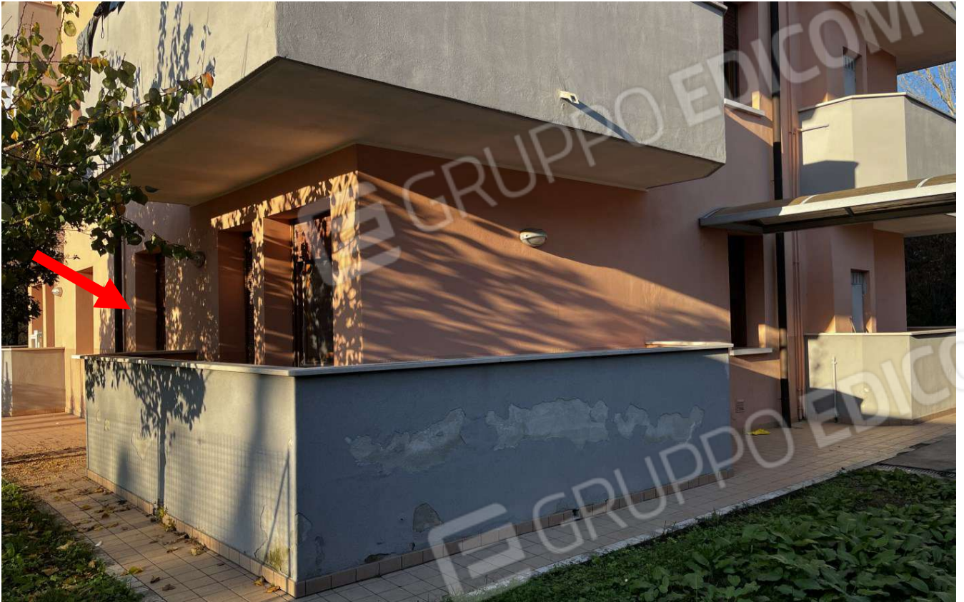
vista di una finestra al piano terra oggetto di difformità edilizia
