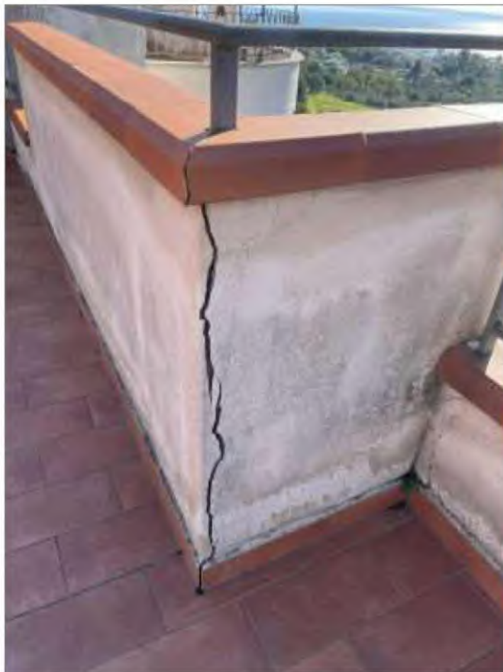
FOTO 25 - Frattura nell'intonaco del parapetto
