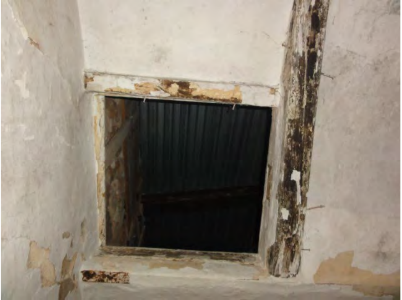
Foto verso l'alto botola nel soffitto si intravede l'intradosso della copertura in lamiera grecata
