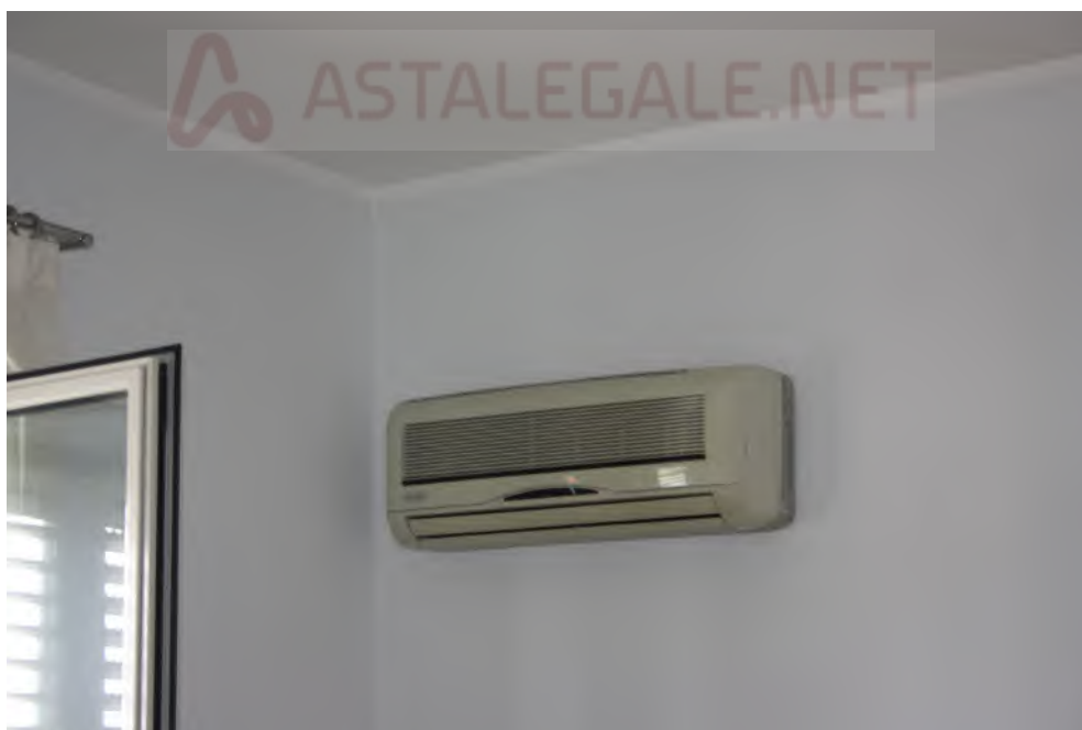
Macchina per aria condizionata (sono presenti n°2 - una in camera da letto e una in cucina)
