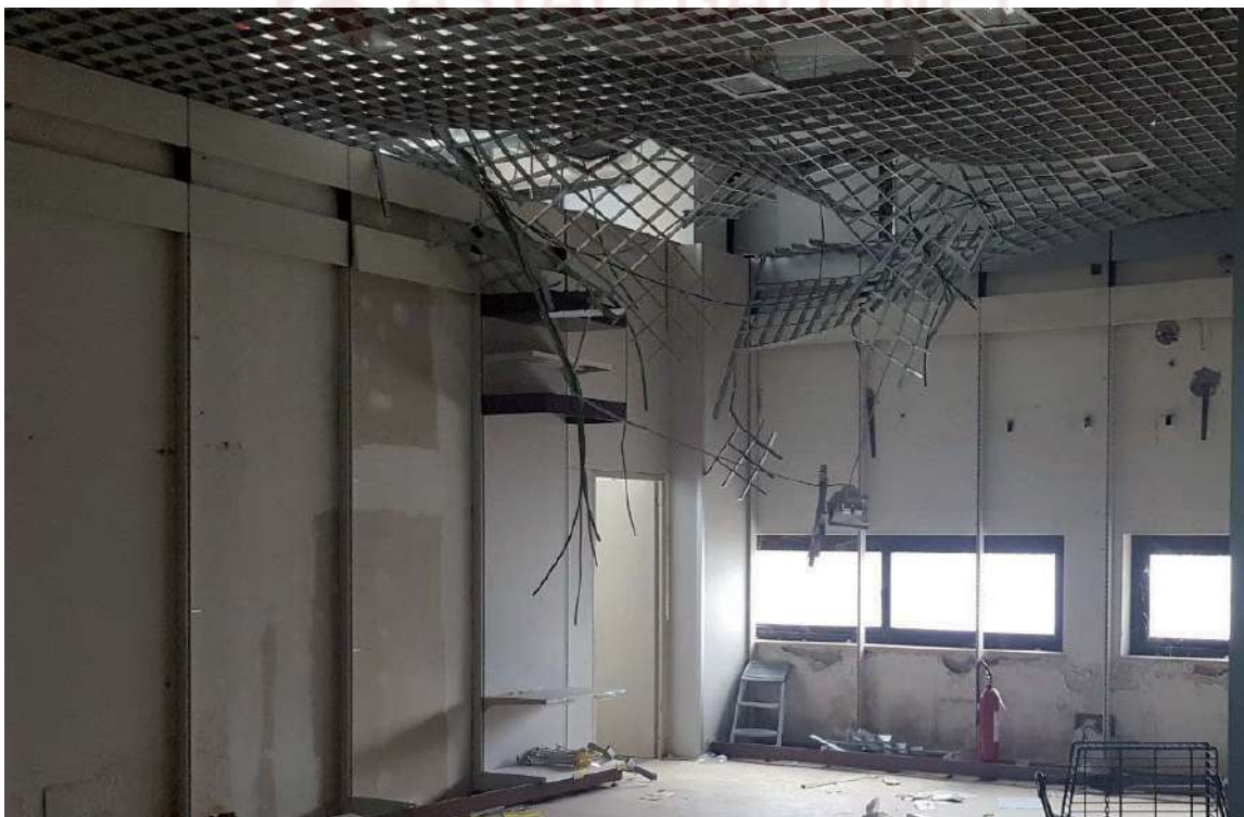
INTERNO (CONTROSOFFITTI VANDALIZZATI)
