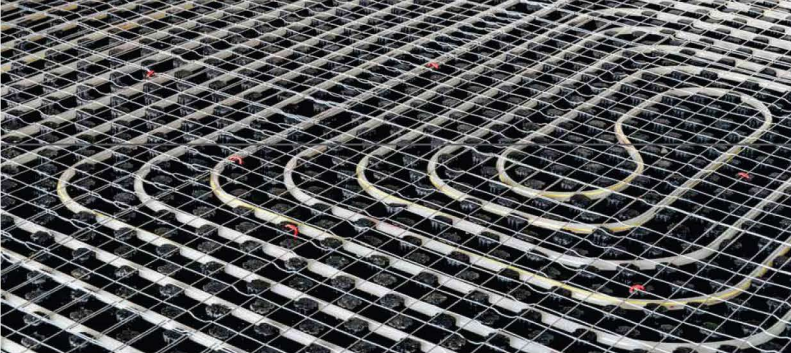
Impianto di riscaldamento
