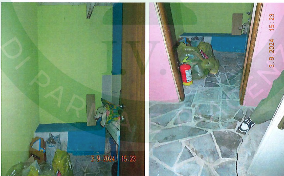
Vano abusivo, adibito a ripostiglio-lavanderia, da regolarizzare mediante sanatoria
