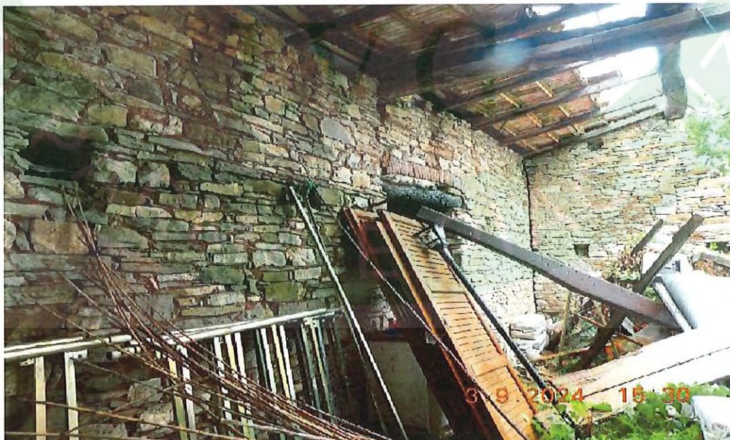
Vano ripostiglio sottotetto su sedime ad est dell'unità abitativa - collabente
