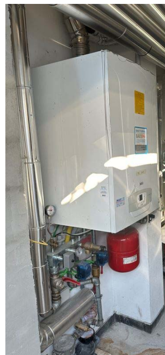
Esempio di caldaia ausiliara
