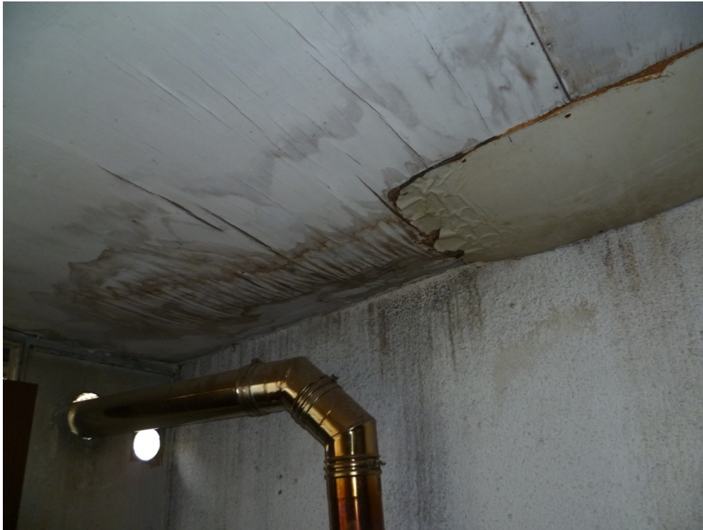
Foto n. 12 – Umidità controsoffitto 2P
