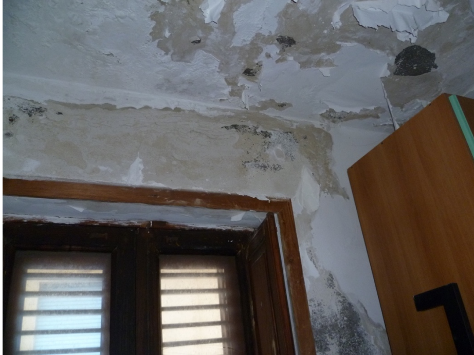
Foto n. 11 – Umidità muro perimetrale 1P
