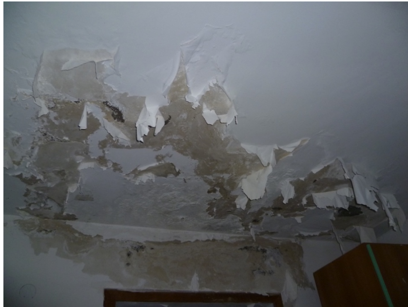
Foto n. 10 – Umidità soffitto 1P
