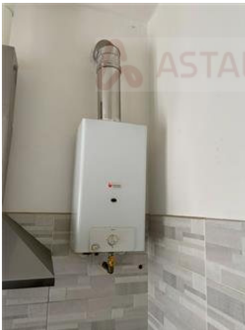
Boiler a gas di tipo a camera aperta con fiamma pilota.
