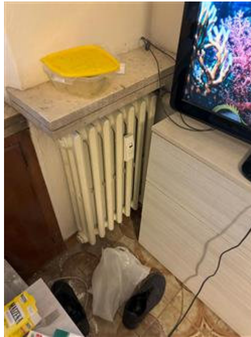
Impianto di riscaldamento centralizzato, dotato di termovalvole e contabilizzatori di calore indiretti.
