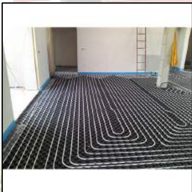
Figura 10: Esempio di impianto di riscaldamento a pavimento
