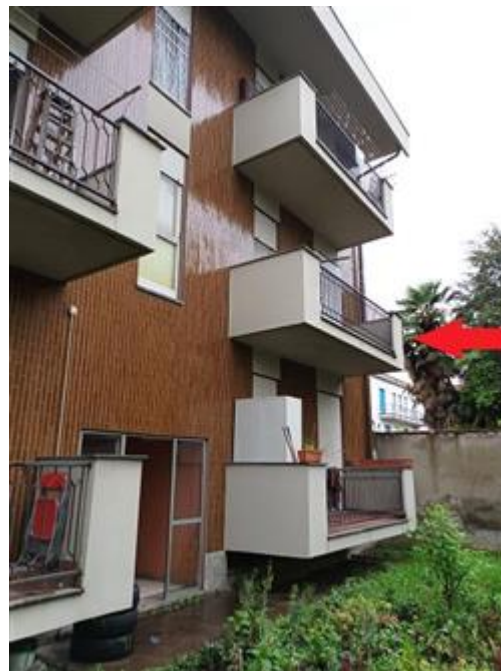
difformità rilevata del balcone
